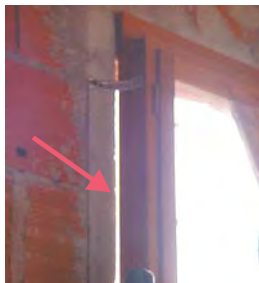
Incompatibilité géométrique entre le tableau et la menuiserie. Le support en l'état n'aurait pas dû être accepté.
