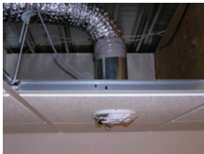
Equipement de régulation de ventilation par détection optique sur petite salle
